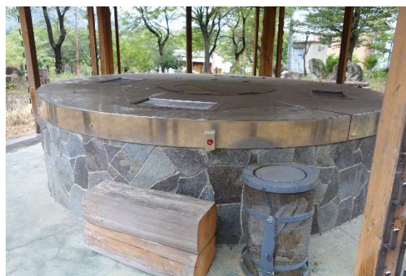
屋外に設置されている集水井
